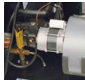
En-faset motor koblet til vifte og dieselpumpe.
